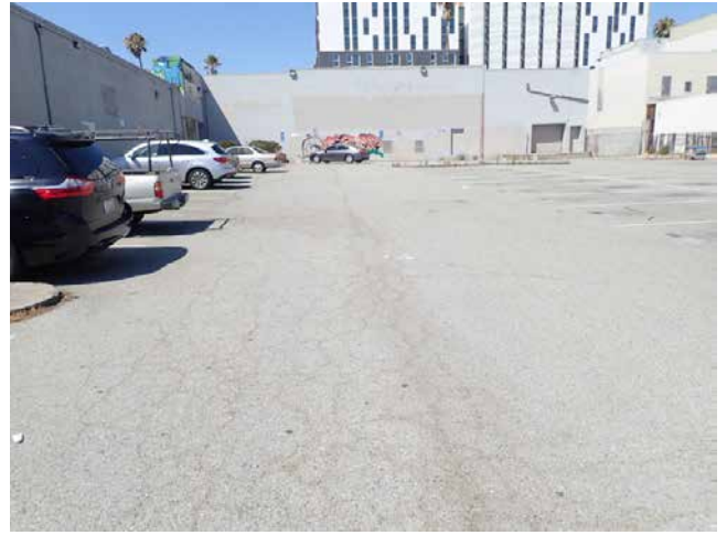
30. Alligatoring asphalt area
