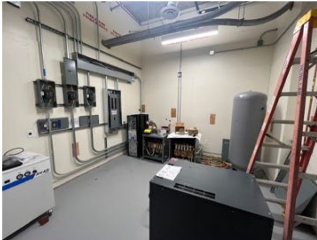
Compressor Room / DI Water Supply
