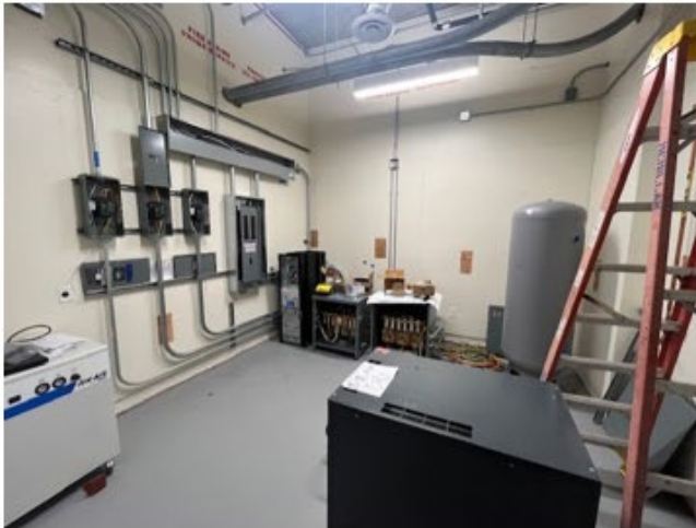
Compressor Room / DI Water Supply
